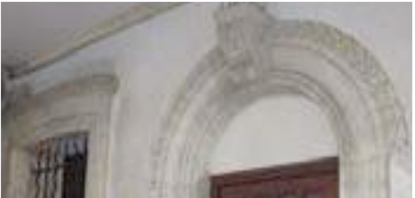
Détails de frises sur les linteaux rez de chaussée. Clé à volutes et feuille d'acanthe.
